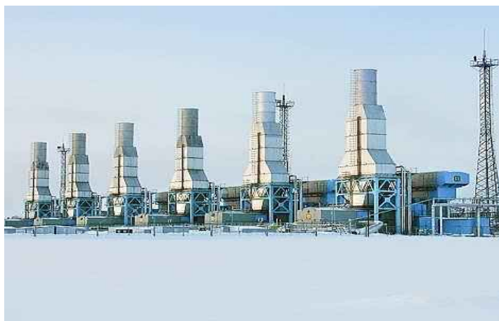
Рис.1 Газотурбинные установки с ВОУ
